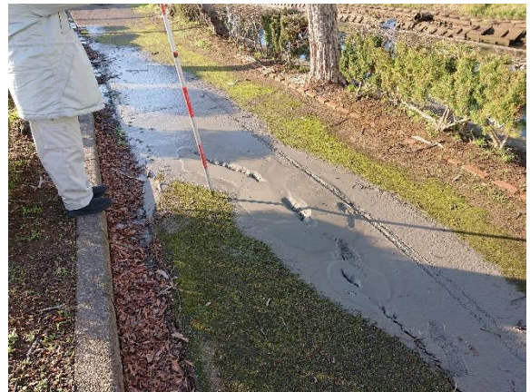
歩道の液状化状況(浜田町)
