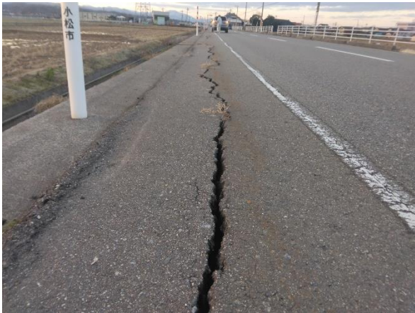
路面ひび割れ状況(北浅井町)
