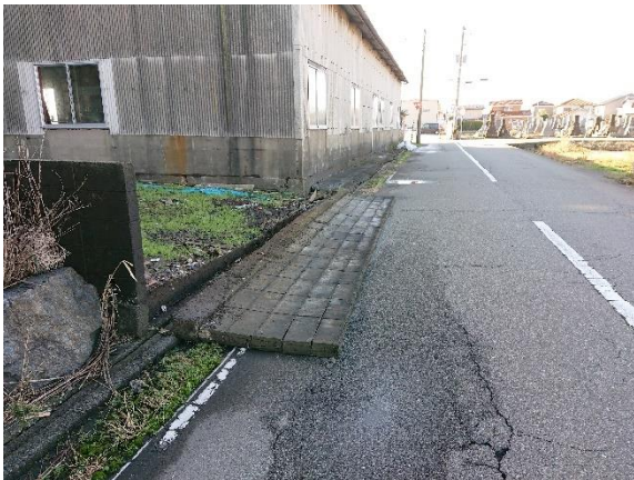
ブロック塀の倒壊状況(長田町)
