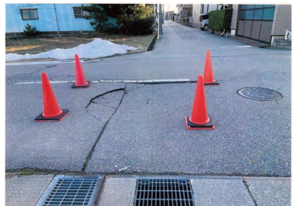
道路の沈下状況(下粟津町)
