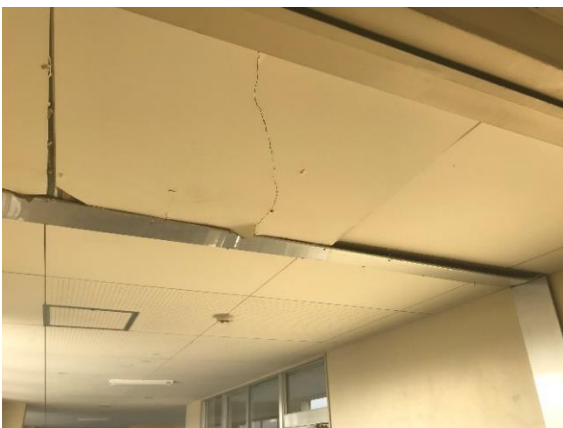
建物内天井破損状況
