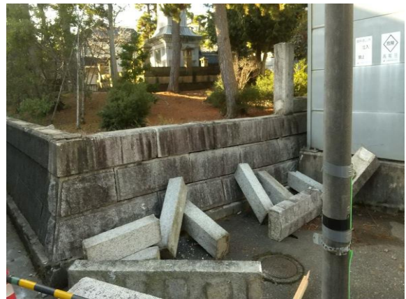
平和塔の周辺の倒壊状況
