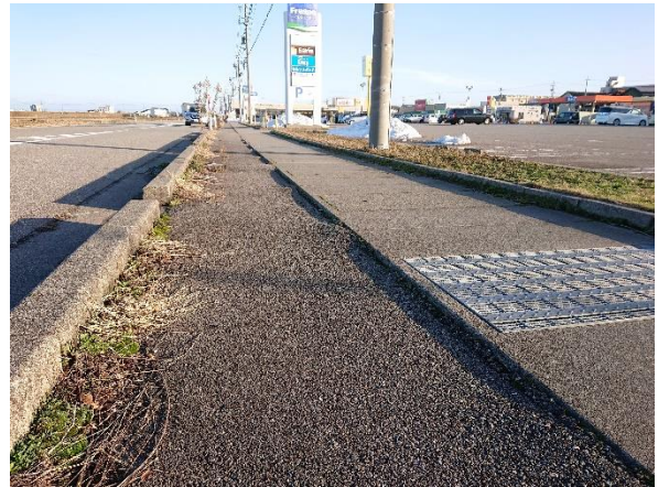
歩道の段差状況(下牧町)
