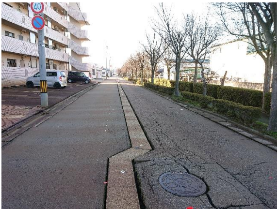
道路陥没状況(浜田町・浮城町)
