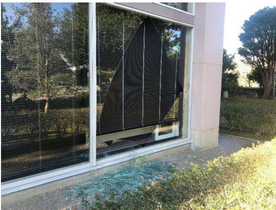
博物館のガラス破損状況
