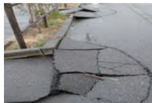
小松市 液状化被害
