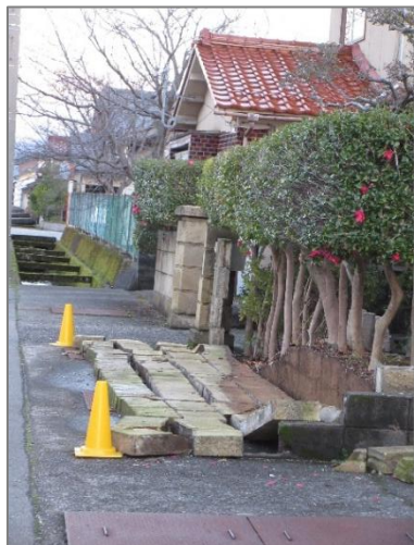
写真① 塀の倒壊
