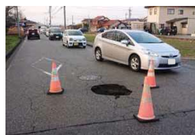
令和8年 H P 管腐食陥没（長崎町地内）
