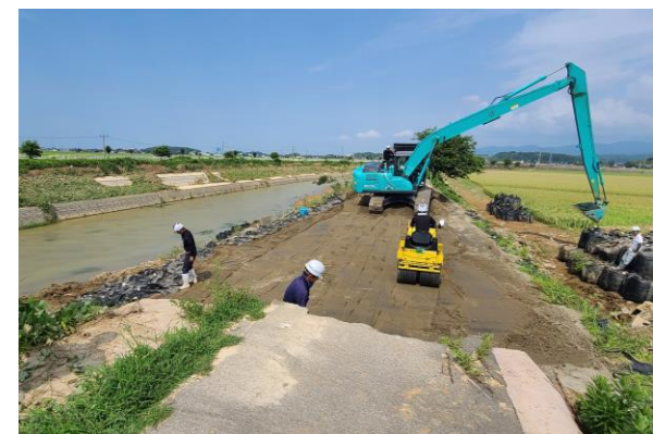
鍋谷川氾濫により破損した堤防（古府町）
