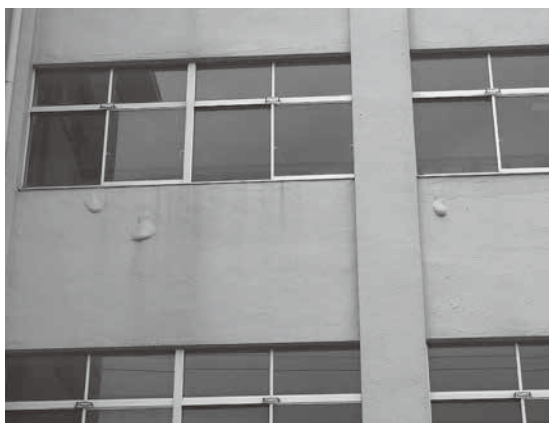
雨水がたまって膨れている外壁(稚松小学校)
