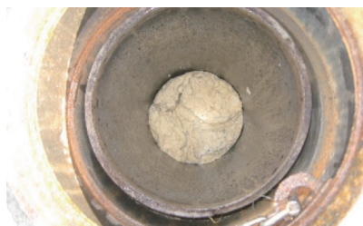
油脂による公共樹の閉塞状況
