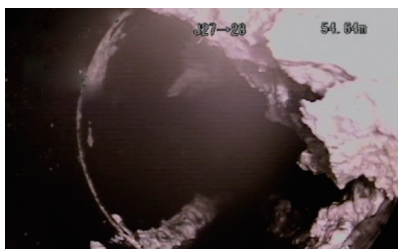
油脂による下水道本管の閉塞状況
