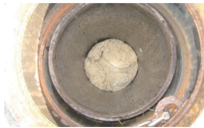
油脂による公共ますの閉塞状況
