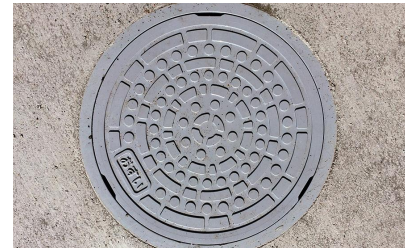
汚水ます(直径15～20cm) ドライバー等により開閉
