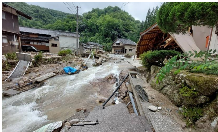
中ノ峠川氾濫に伴う配水管破断
