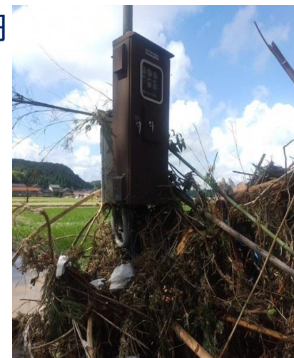
中海地区マンホールポンプ 制御盤への流木
