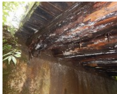
損傷例：木橋の腐朽
