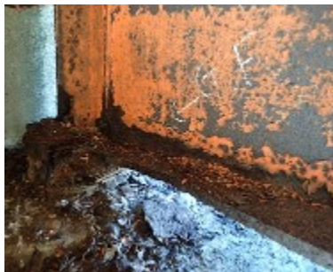
損傷例：橋桁の塗装のはがれ、腐食
