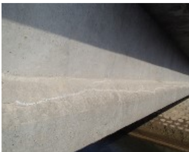
損傷例：橋桁のひびわれ
