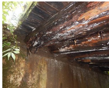
損傷例：木橋の腐朽
