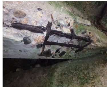
損傷例：コンクリート主桁の鉄筋露出
