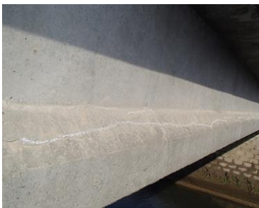
損傷例：橋桁のひびわれ
