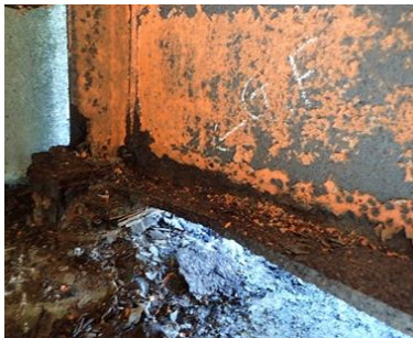
損傷例：橋桁の塗装のはがれ、腐食
