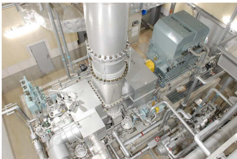
クリーンセンター蒸気タービン・蒸気発電機
