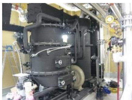
木質バイオマス※温水ボイラー（せせらぎの郷）
