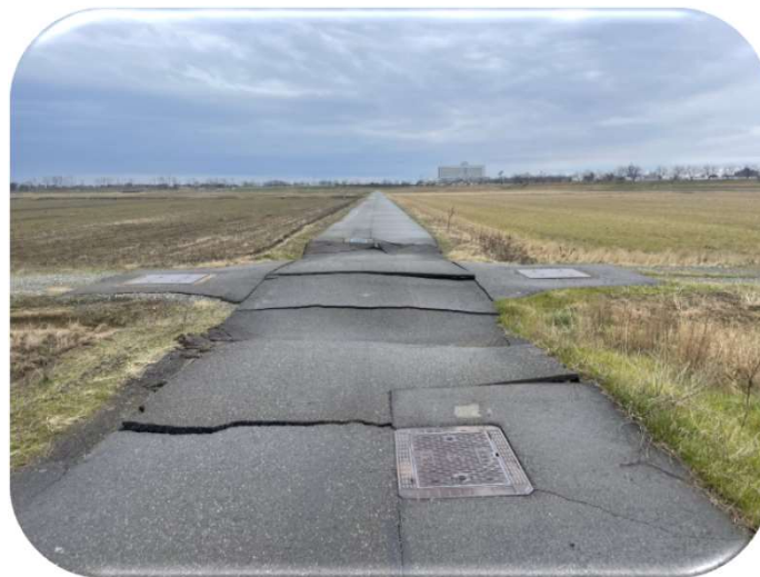
【農道】 地震災害陥没
