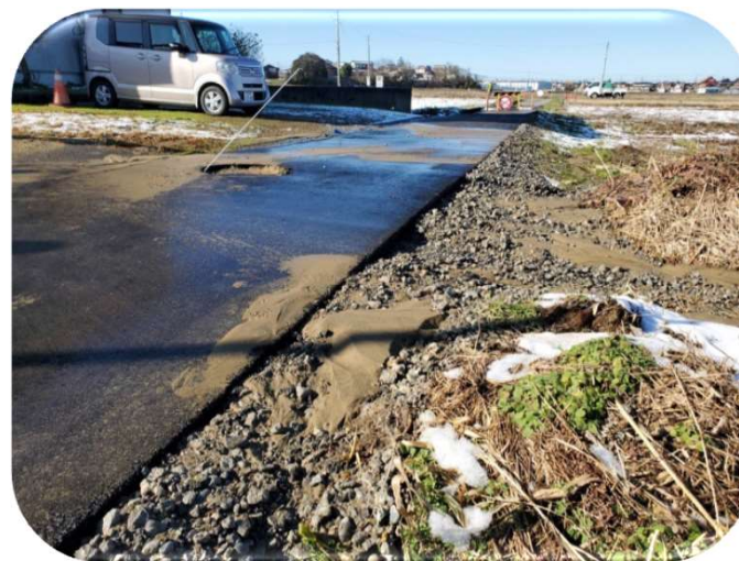
【パイプライン】 地震災害漏水
